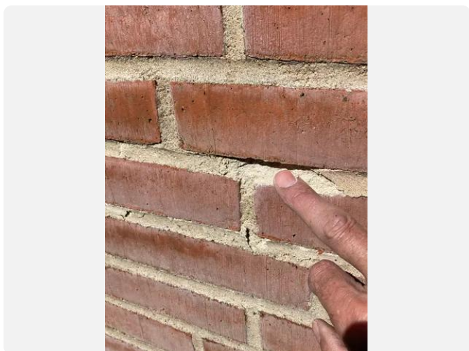
Defekte fuger hus 2
