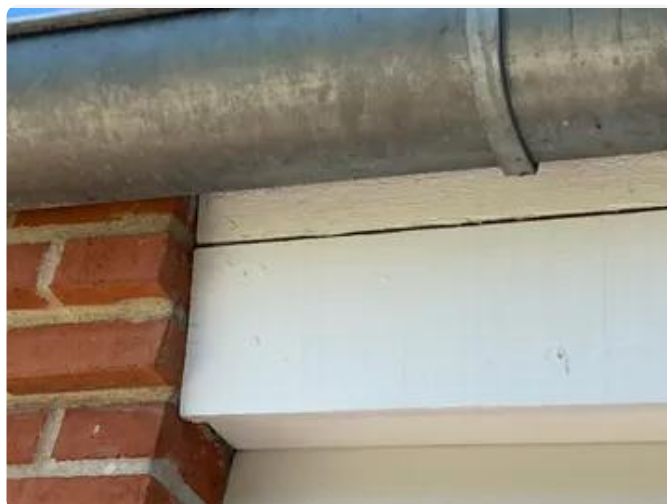
Bræt over terrasseparti med mindre revne
